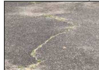
Béton dégradé et sans usage.
